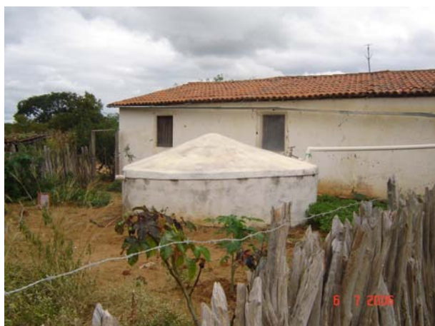
FOTO 3: Cisterna de placas (capacidade de 16m 3 )
